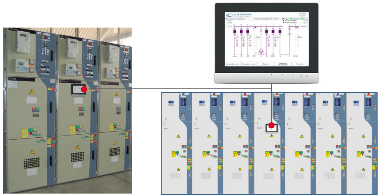
Рис. 39. КРУ «Элтима», оснащенная системой мониторинга и управления с локальной панелью визуализации
