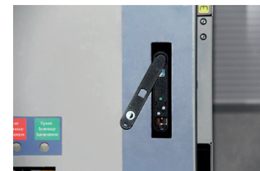
Рис. 19. Открывание дверей отсеков
