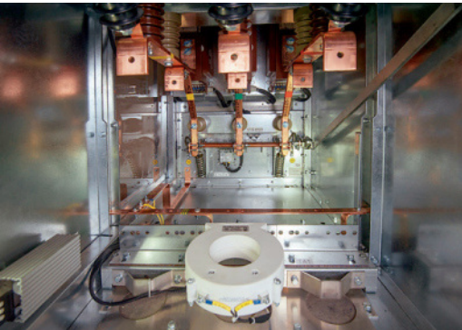
Рис. 24. Отсек присоединений с открытой дверью
