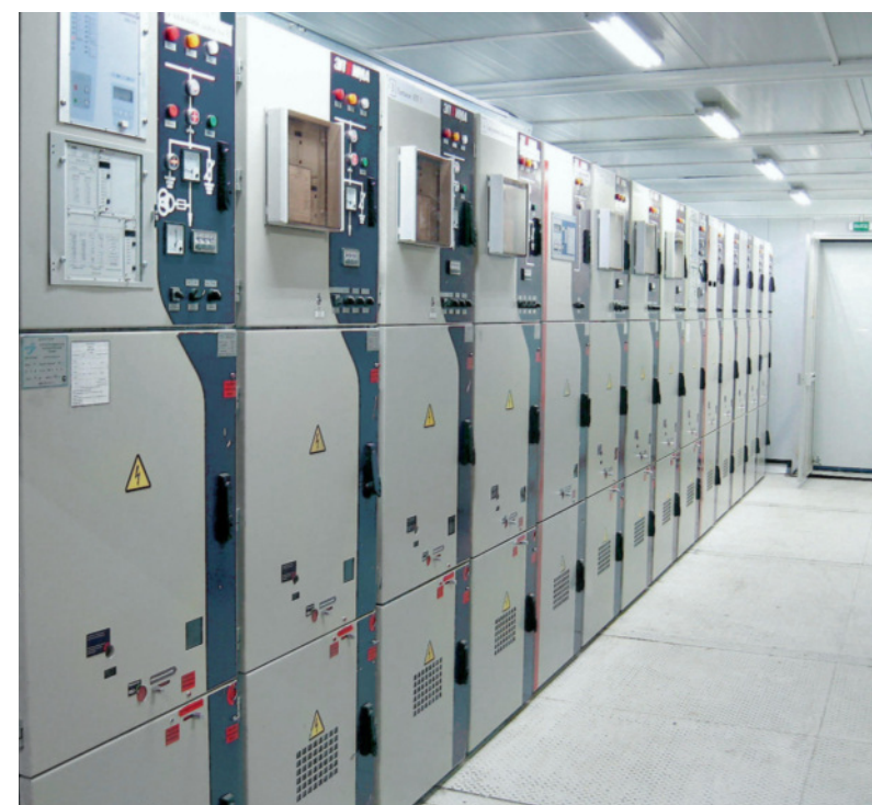
Рис. 45. Закрытое распределительное устройство 10 кВ со шкафами КРУ «Элтимаш»
