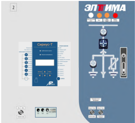
Рис. 7. Шкаф ввода с МП РЗА и индикатором наличия напряжения
