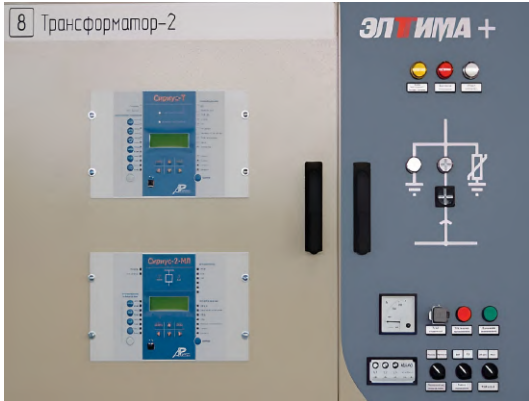
Рис. 15. Фасадная дверь отсека вспомогательных цепей
