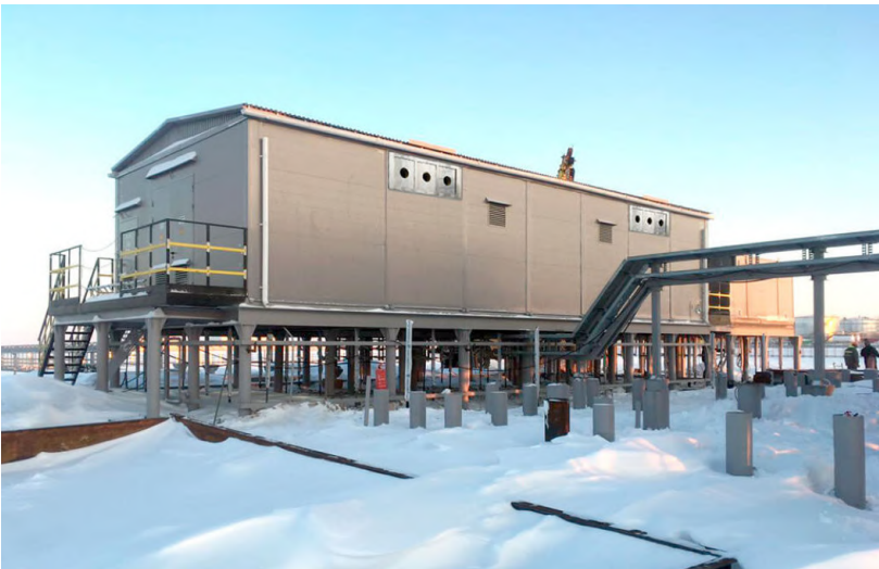
Рис. 26. ЗРУ 35 кВ высокой заводской готовности
