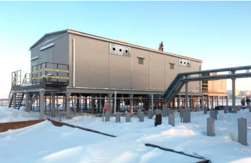
Рис. 28. ЗРУ-35 кВ высокой заводской готовности
