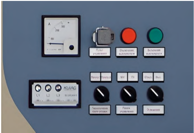
Рис. 15. Индикатор наличия напряжения в составе шкафа КРУ «Элтима+»
