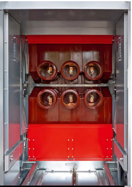
Рис. 10. Шторочный механизм в отсеке ВЭ
