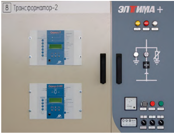
Рис. 14. Фасадная дверь отсека вспомогательных цепей
