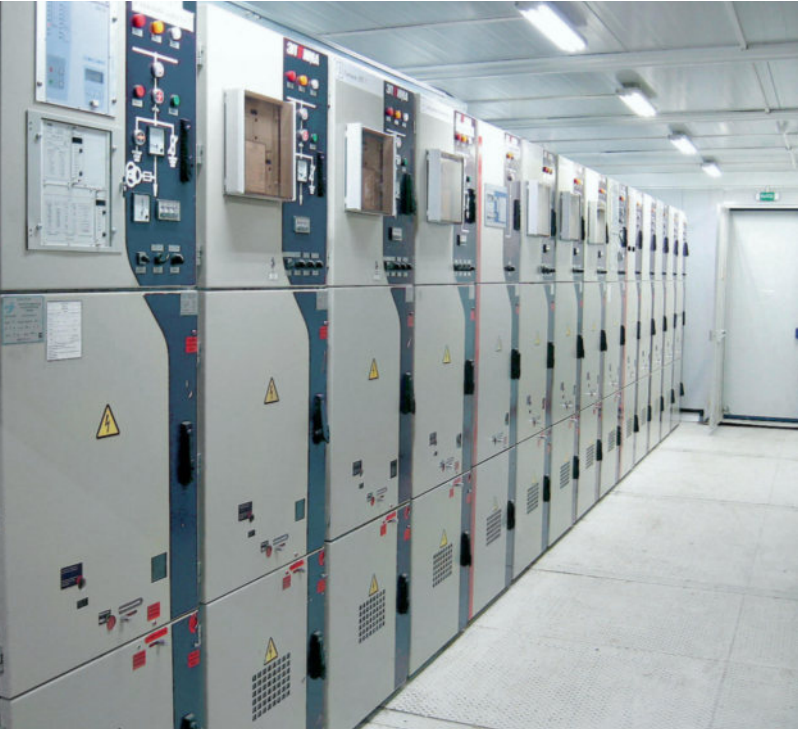
Рис. 44. Закрытое распределительное устройство 10 кВ со шкафами КРУ «Элтима»
