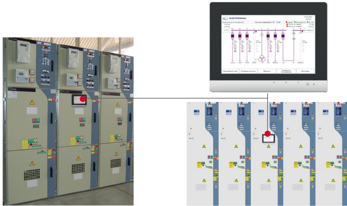
Рис. 39. КРУ «Элтима», оснащенная системой мониторинга и управления с локальной панелью визуализации
